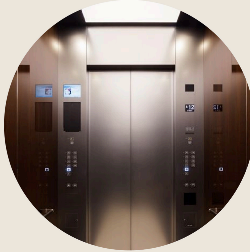
ascensor en cada edificio
